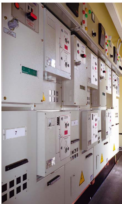
// Распределительное устройство на базе ячеек КСО «Онега» в БКРПБ //
