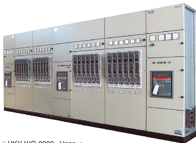
\\ НКУ ЩО-2000 «Нева»: 2 секции, 24 отходящих присоединения с защитой предохранителями, секционный автоматический выключатель
