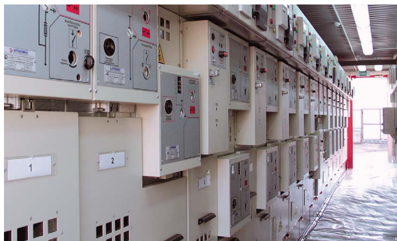
// Распределительное устройство в металлической оболочке на базе ячеек КСО «Онега» //
