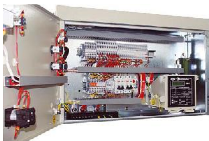
\\ Отсек релейной защиты \\
