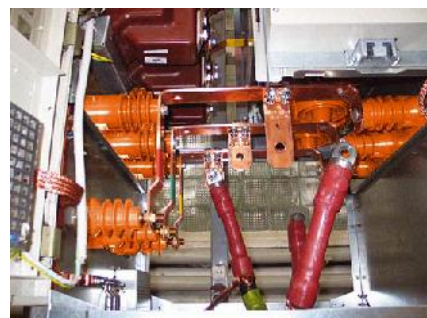
// Фронтальное подключение силового кабеля //
